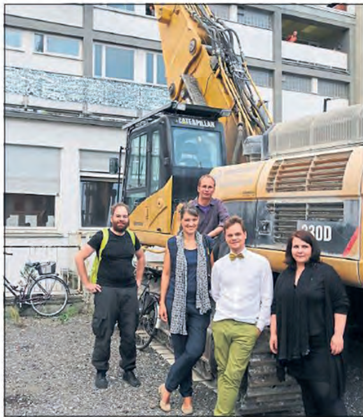
Daniel Schnier und Oliver Hasemann (Zwischen-Zeit-Zentrale Bremen), Karin Hartmann (Koordinatorin Zwischennutzung Königsplätze), Tim Pickartz und Miriam Schröder (Leitung Perspektive: Abriss/von links) bei der Veranstaltung im ehemaligen HoT in der Marienstraße.
